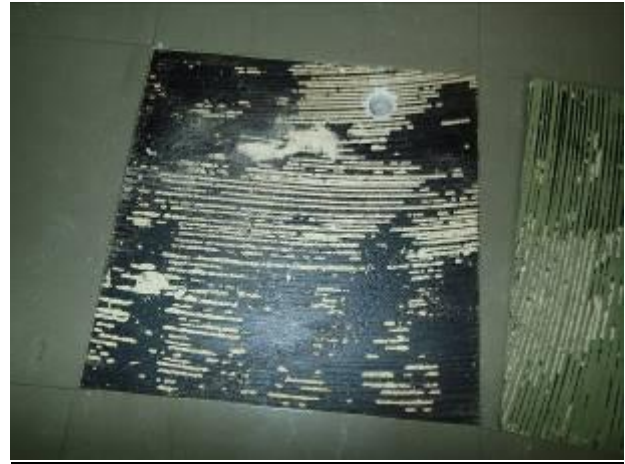
Kuva 38. Tilan 121 alapohjan vinyyli-pinnoitteen kiinnitykseen käytetty mustaa liimaa. Liimasta otettiin materiaalinäyte asbestimäärittystä varten. Näytteessä todettiin olevan asbestia.
