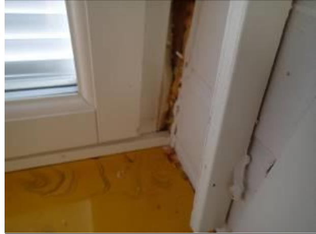
Kuva 20. Avattiin ikkunan pielilistaa. Ikkunan karmin ja kiinnityspuun väli tiivistetty uretanivaahdolla, kohdassa epätiiveyttä.
