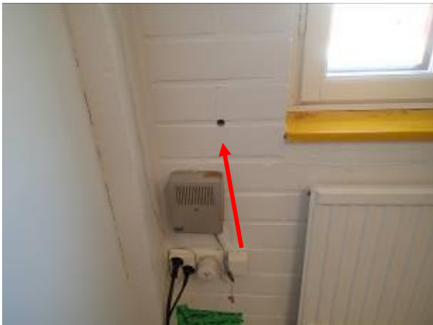
Kuva 17. Samassa pystylinjassa otettiin ulkoseinän mineraalivillasta materiaalinäyte 2, LP-tasosta +750 mm. Näytteessä ei mikrobikasvua.
