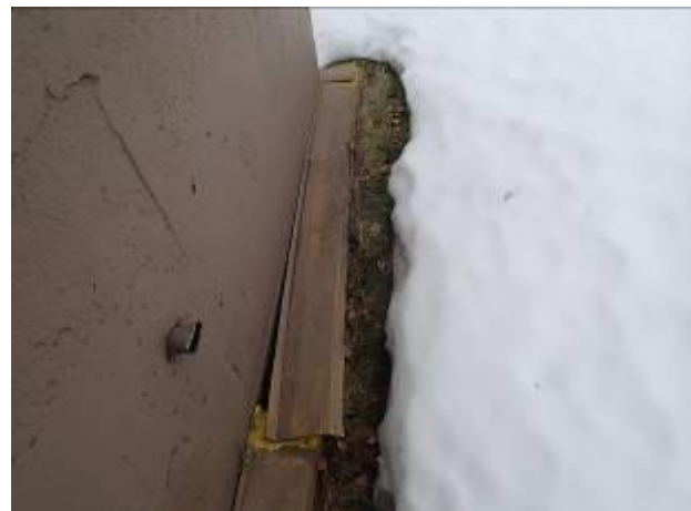
Kuva 8. Vedenohjainlista on paikoin irti seinästä.
