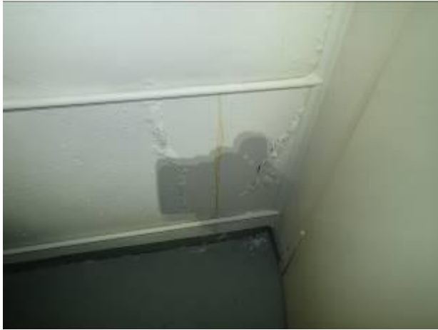
Kuva 55. Väestönsuojan maanpainesseinissä maali on paikoin kupruillut/lohkeillut.
