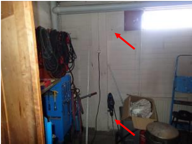
Kuva 36. Varaston ulkoseinään tehtiin rakenneavaus (RA6) LP-tasosta + 150 ja 1980 mm. Rakenneavauskohdasta otettiin materiaalinäyte 14-15. Molemmissa näytteissä on epäily mikrobikasvusta.
