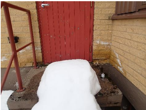
Kuva 3. Opetustila 121 takaoven vieressä tiiliverhouksen alaosassa on silminnähtävää kosteutta ja kalkkihärmää sekä tiilissä pakkasrapautumista.
