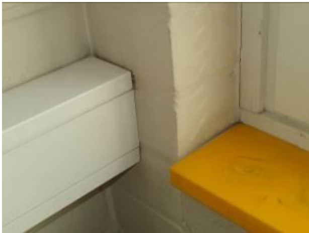
Kuva 67. 1.kerroksessa ikkunan ja seinien liittymissä epätiiveyttä ja ilmavirtausta huonetiloihin päin.
