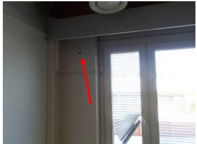
Kuva 18. Samassa pystylinjassa otettiin ulkoseinän mineraalivillasta materiaalinäyte 3, LP-tasosta +2000 mm. Näytteessä ei mikrobikasvua.
