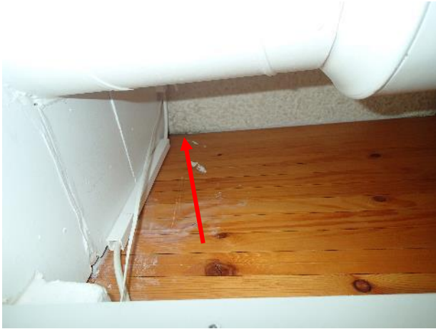
Kuva 21. Liimapuu palkin ja katon siporex-elementin liittymässä näkyy ”pölyviiksiä”, viittaavat ilmavirtauksiin rakenteesta huonetilaan päin.
