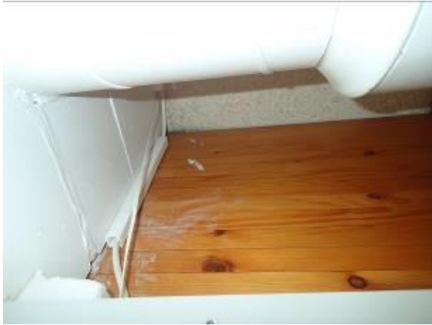
Kuva 59. Oleskelutila 120 puukattopalkin ja katon siporex-elementin liitoksessa näkyy ”pölyviikset”.
