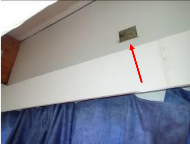
Kuva 37. Tilan 121 ulkoseinän yläosan sisäpinnanlevytyksestä otettiin materiaalinäyte asbestimäärittystä varten. Näytteessä todettiin olevan asbestia.
