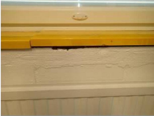
Kuva 19. Ikkunapenkin ja seinärakenteen liitos on osittain auki, ilmavirtausta sisälle päin (ikkunat vaihdettu noin 10 vuotta sitten).
