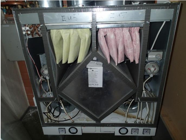
Kuva 71. TK/PK02 ilmanvaihtokoneen yleiskuva.
