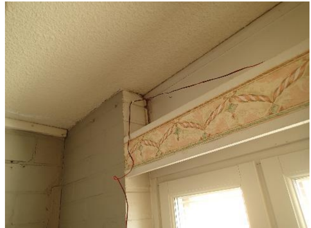
Kuva 50. Levyrakenteisen ja tiilirakenteen liittymää ei ole tiivistetty.
