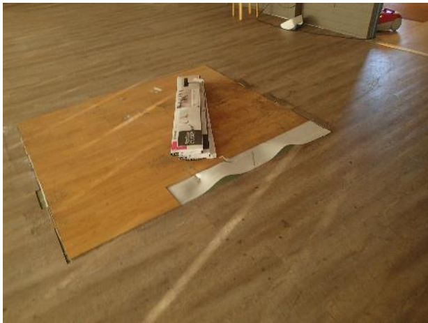
Kuva 51. Lattian pinnoite on uusittu jokin aika sitten. Huoneen keskellä pinnoite on erilainen (mahdollinen paikkakorjaus).
