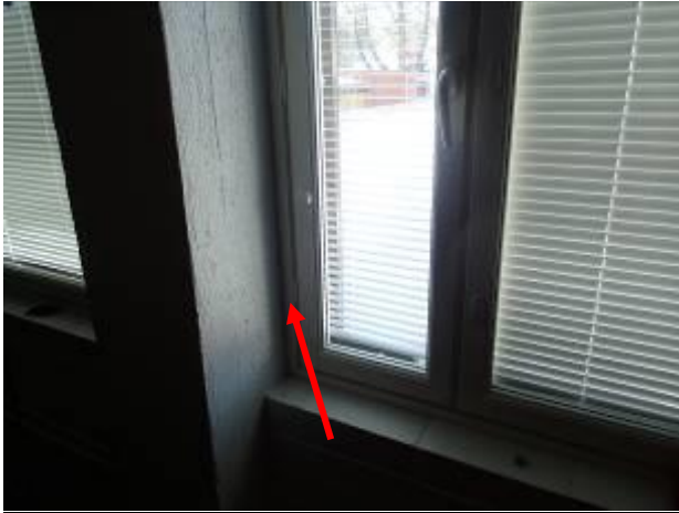
Kuva 26. Ikkunan ja seinä/pilari liittymien saumat ovat osittain auki, ilmayhteys rakenteista huonetilaan.
