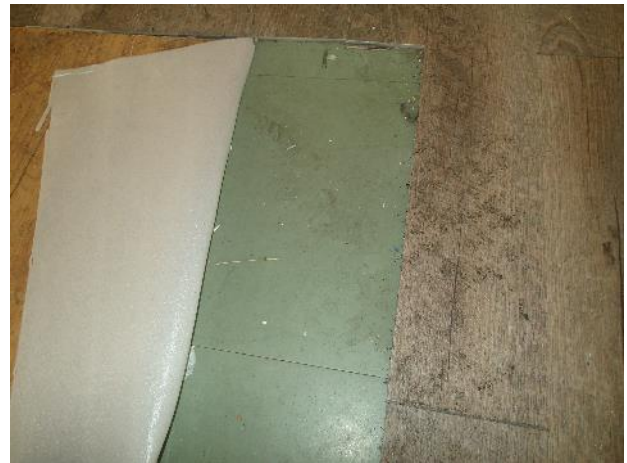
Kuva 52. Nykyisen pinnoitteen alla oli vanha lattiapinnoite. Vanhan pinnoitteen liimassa on asbestia.
