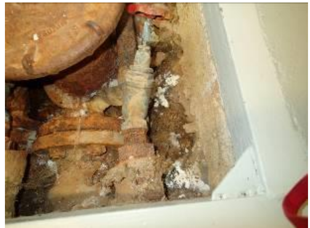
Kuva 54. Luukussa on maapohja.
