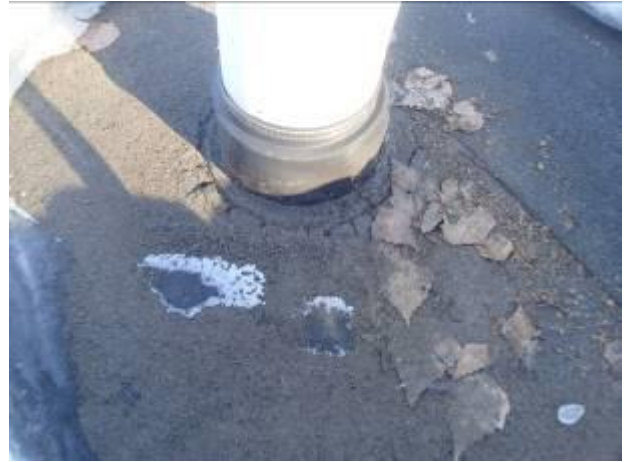
Kuva 14. Muutamien vesikaton läpivientien kohdilla huopakate/kuumapiki on halkeillut.
