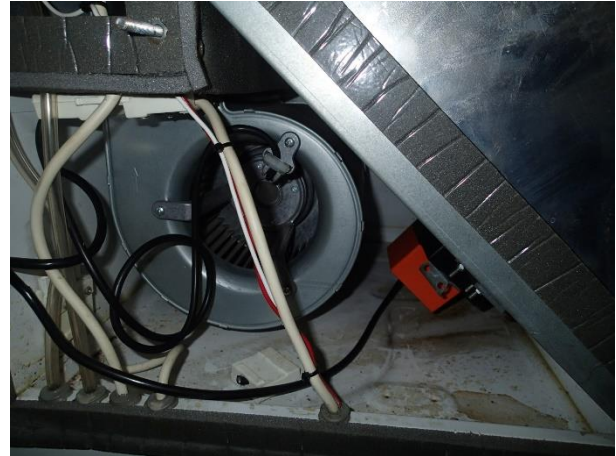
Kuva 72. Ilmanvaihtokoneen pohjalla roskaa/pölyä ja vanhoja kosteus-/öljyjälkiä.
