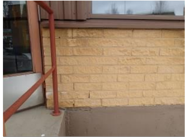
Kuva 2. Yläpihan puolella pääoven vieressä tiilimuurauksessa on kalkkihärmää ja saumat halkeilleet.
