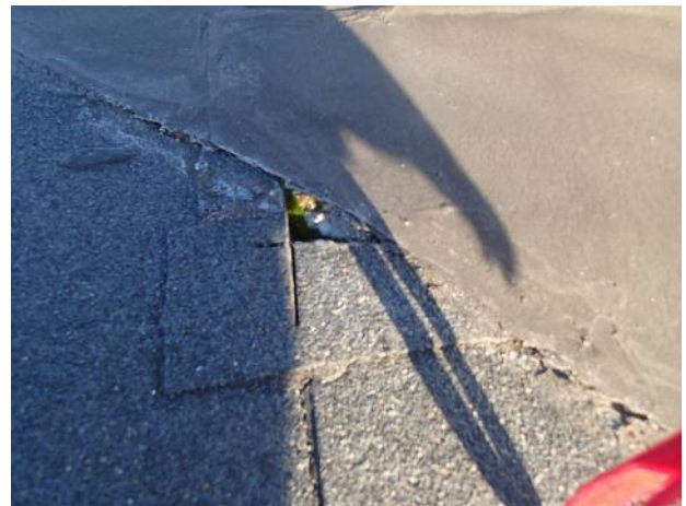
Kuva 12. Lähikuva huolimattomasta läpiviennin teosta/korjaamisesta. Vanhan huopakatteen leikkaamisen paikkaus ei yllä koko leikatun kohdan ylitse.
