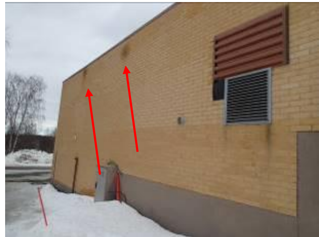
Kuva 6. Päätyseinän kahdessa kohdassa tiilimuurauksessa on kosteusjälkiä (reunapellin liitos). Lumi kerääntynyt sokkelin varteen ja sulassa aiheuttaa kosteusrasitusta sokkelirakenteisiin.
