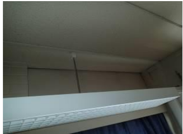
Kuva 33. Ikkunan yläpuolella ulkoseinän levyrakenteen ja katon siporex-elementin liittymä oli avoinna ja tiivistämätön.
