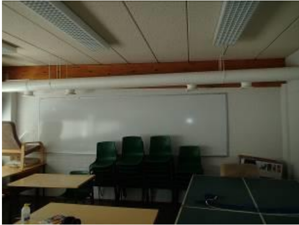
Kuva 63. Opetustilan katon siporex-elementin päissä epätiiveyttä.
