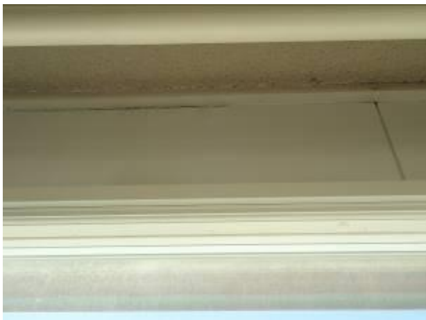
Kuva 69. 1.kerroksessa katon ja seinien liittymissä epätiiveyttä ja ilmavirtausta huonetiloihin päin.
