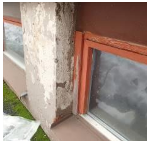
Kuva 4. Letkutornin käytävä sokkelirakenteiden pinnoitteet ovat osittain rapisseet irti. Ulkopuolinen kosteus räsittää myös ikkunarakenteita.
