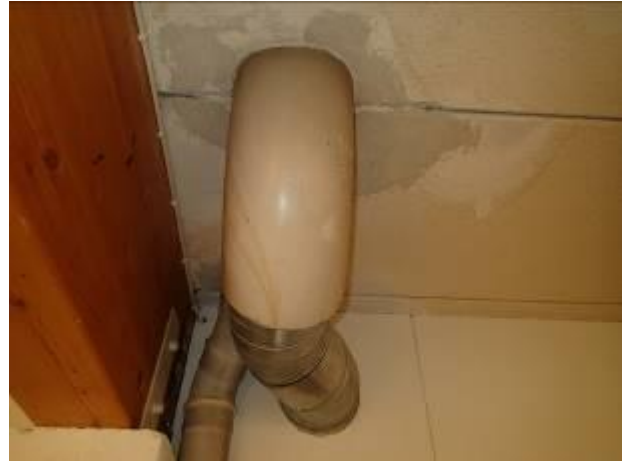
Kuva 44. Yläpohjan läpivienneissä on vanhoja valumajälkiä.
