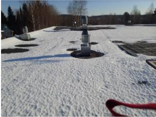
Kuva 9. Vesikatolla oli tarkasteltu hetkellä lunta, koko vesikaton kuntoa ei voitu tarkastella.
