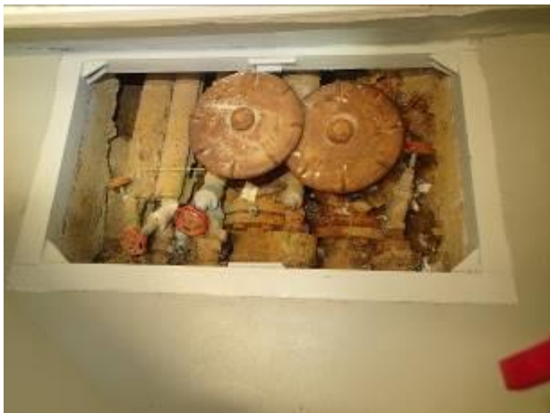
Kuva 53. Väestönsuojan lattiassa on luukku, luukun alla on vesiputkien sulkuventtiilit.
