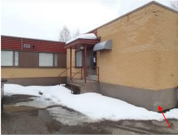
Kuva 1. Yläpihan puolella maan kallistukset vähäisiä, talvisin lumi kasaantuu seinien varsille. Perustusten maali-pinnoissa on kosteuden aiheuttamia jälkiä.
