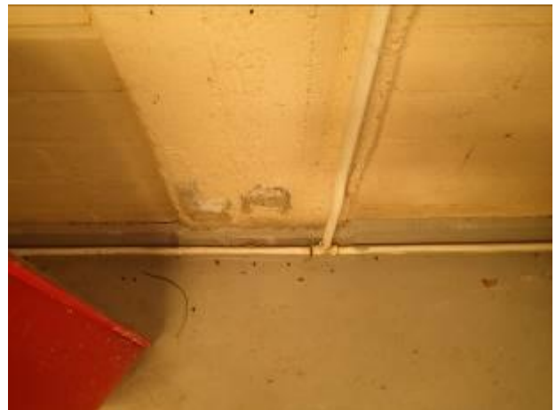
Kuva 40. Kellaritiloissa pilareiden alapäiden maalipinta on osittain halkeilut.
