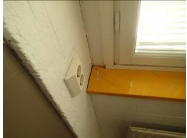
Kuva 48. Ikkunapenkin ja seinärakenteiden liittymät ovat tiivistämättömiä.
