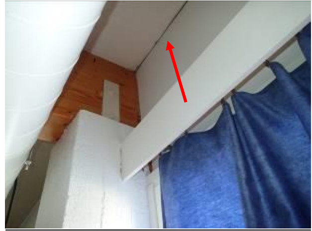
Kuva 27. Katon siporex-elementin ja seinän liittymät ovat osittain auki, ilmayhteys rakenteista huonetilaan.
