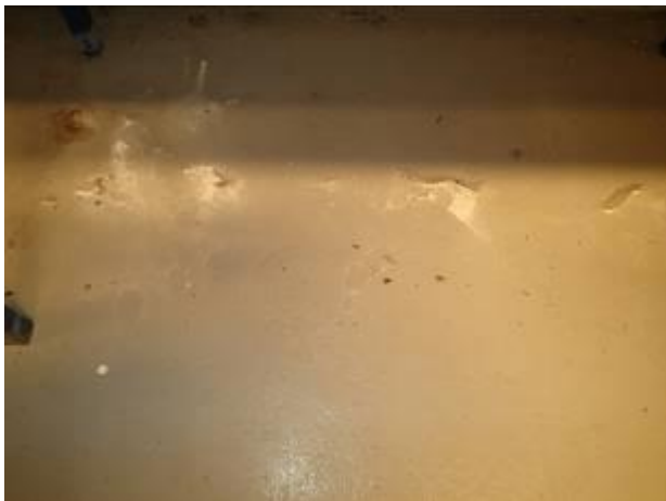
Kuva 39. Kellaritiloissa lattian maalipinta on osittain halkeilut.
