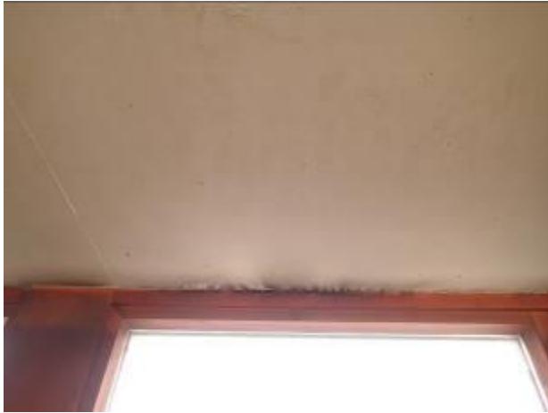
Kuva 43. Kellarikerroksessa on vanhat alkuperäiset ikkunat. Paikoin ikkunoiden yläpuolella katossa näkyy "pölyviiksiä", jotka kertovat ilmavirtauksista huoneita päin.
