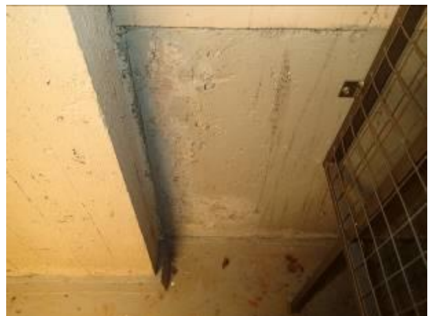
Kuva 42. Kellaritiloissa maanpaineiseinissä maalipinta hilseilee paikoitellen.
