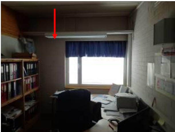
Kuva 32. Palopäällikön huoneen ulkoseinään tehtiin rakenneavaus (RA5) samassa linjassa LP-tasosta + 100 mm, + 830 mm ja + 2150 mm. Rakenneavauskohdista otettiin materiaalinäytteet 10-12. Näytteessä 10 on epäily mikrobikasvusta, näytteessä 11 selvää mikrobikasvua, näytteessä 12 ei mikrobikasvua.
