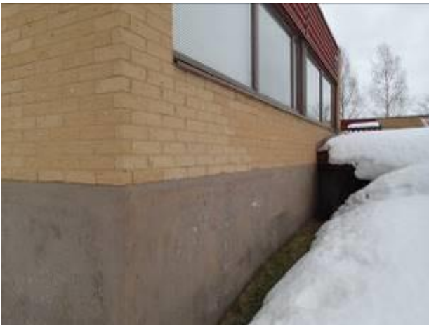
Kuva 5. Multainen maa-aines on kiinni sokkelirakenteessa.
