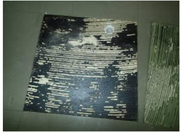
Kuva 29. Vinyylilaatan irrotuksen yhteydessä havaittiin mustaa liimaa. Liimasta otettiin asbestinäyte, näyte sisälsi asbestia.
