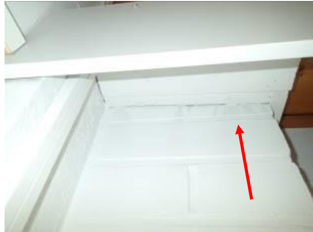
Kuva 22. Verhokotelon ja tiilimuurauksen liittymässä näkyy ”pölyviiksiä”.
