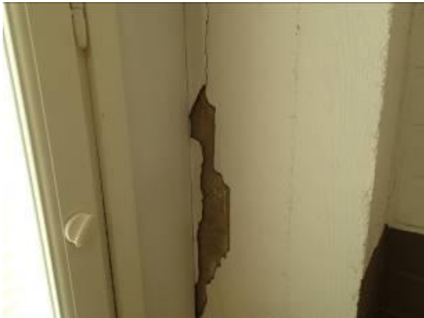
Kuva 49. Ikkunan ja pilarin liittymässä on halkeamia ja tiivistämättömiä kohtia.
