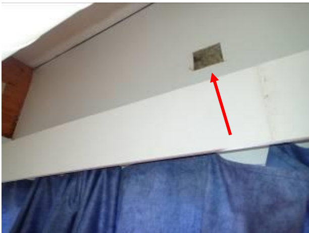
Kuva 25. Ikkunan yläpuolelle LP-tasosta + 2530 mm tehtiin rakenneavaus. Sisäpinnan lujalevystä otettiin asbestinäyte 1, analyysituloksen perusteella materiaalinäyte sisältää asbestia. Lisäksi ulkoseinän eristeestä otettiin materiaalinäyte 6 (mineraalivilla). Näytteessä ei mikrobikasvua.
