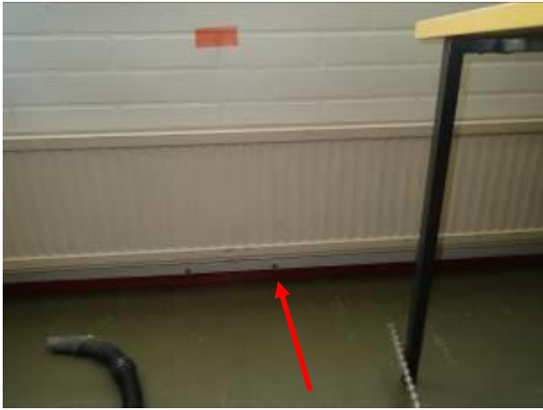
Kuva 23. RA2, tehtiin oleskelutila 121 ulkoseinään ikkunan alapuolelle, LP-taso + 40 mm. Ulkoseinän eristeestä otettiin materiaalinäyte 4 (mineraalivilla). Näytteessä oli selvää mikrobikasvua.
