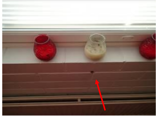
Kuva 24. Ikkunan alapuolelle LP-tasosta + 740 mm tehtiin rakenneavaus, ulkoseinän eristeestä otettiin materiaalinäyte 5 (mineraalivilla). Näytteessä oli selvää mikrobikasvua.
