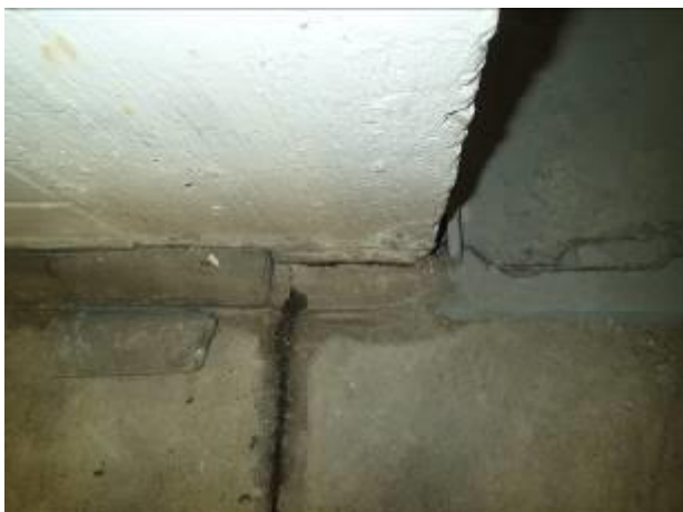
Kuva 41. Kellaritiloissa pilareiden ja lattian betonilaatan liittymät ovat osittain auki.
