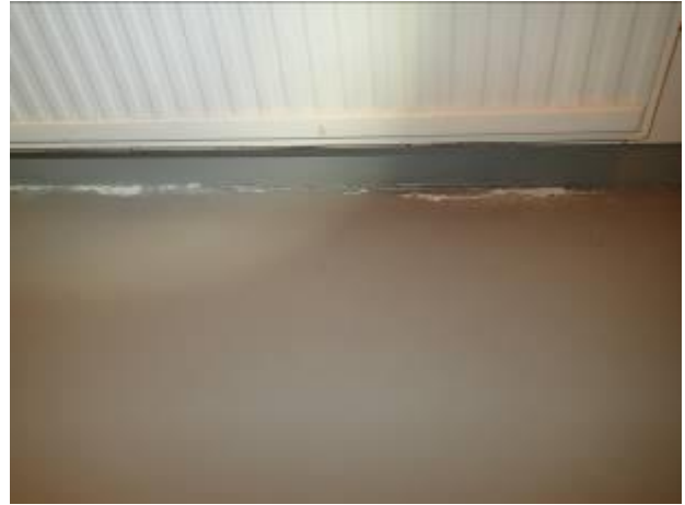
Kuva 56. Väestönsuojan lattiassa paikoin maali on kupruillut.
