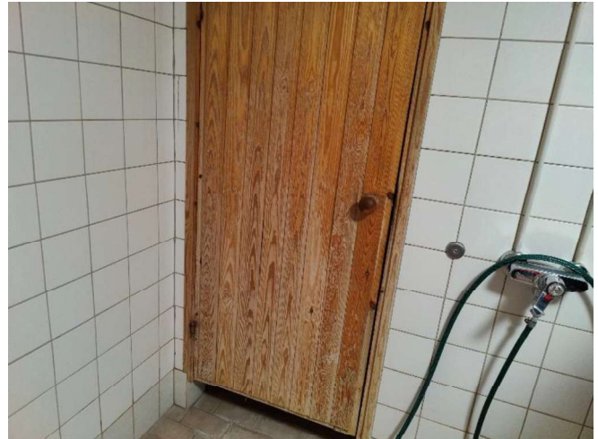
Kuva 72. Saunan paneeliövi voimakkaasti kulunut.
