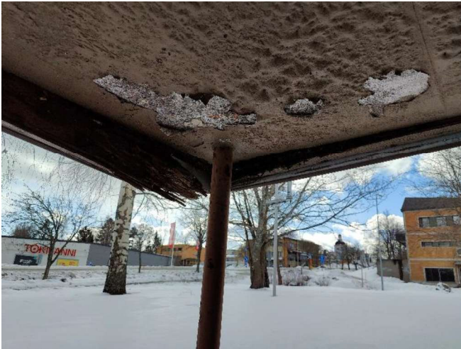
Kuva 44. Kosteutta betonilaatan alapinnassa (päädyn sisääntulotaso).
