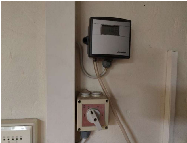
Kuva 104. Ilmanvaihdon käyttökäytin ja toimilaite.
