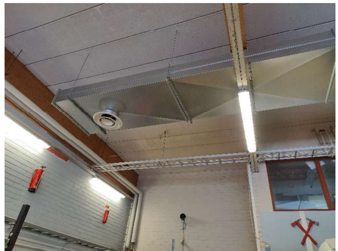
Kuva 130. Yleiskuva, hallin valaisin.
