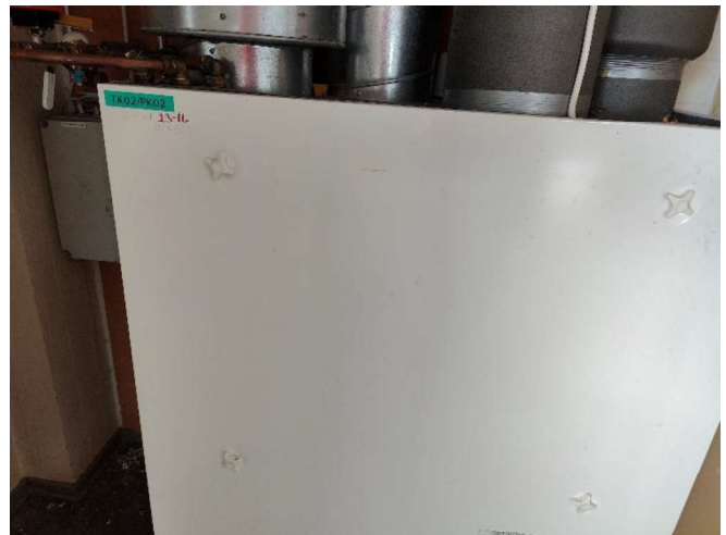
Kuva 99. Yleiskuva IV-koneesta TK/PK02.
