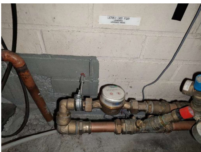
Kuva 90. Vesimittari ja päävesisulku.
