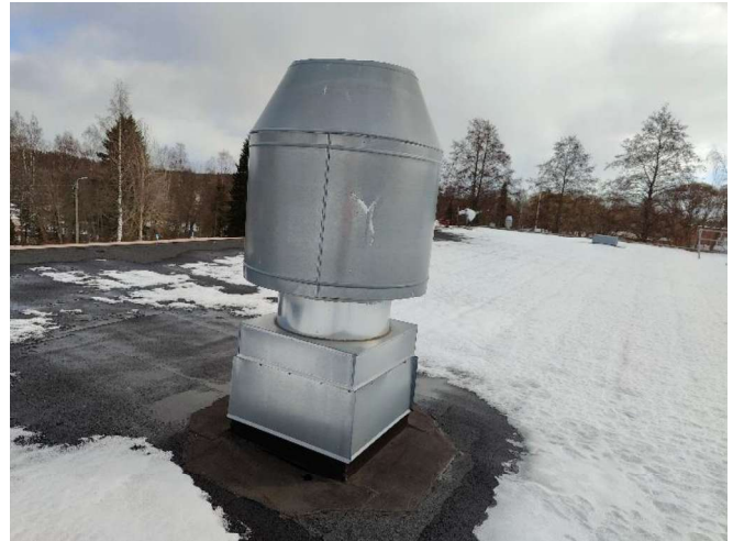
Kuva 109. IV-koneen poistoilmahajoittaja PK05.
